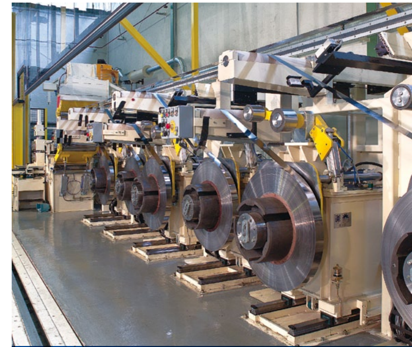
Dünnbandlängsteilanlage mit acht Aufwickelhaspeln und Saumschrottabsaugung
